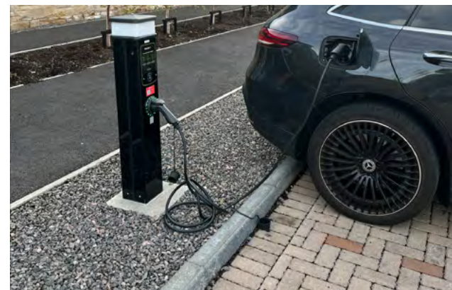
トマーチン社 電気自動車充電スポット
