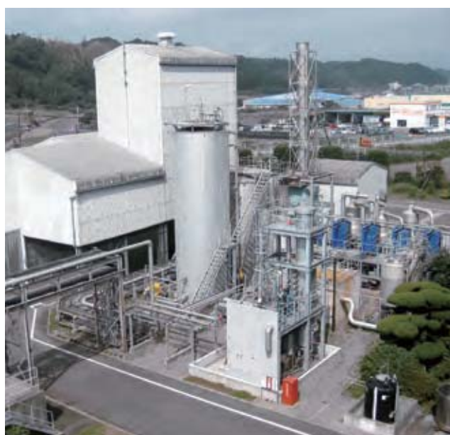
焼酎粕の飼料化設備 黒壁蔵で発生する焼酎粕を飼料化して有効利用しています。
