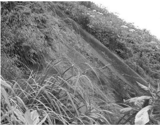
図 29. 島東面の斜面の崩落防止ネット
