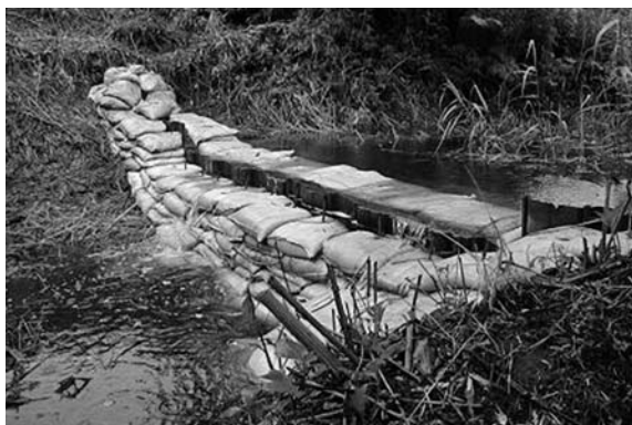
写真 3 水路に設置された堰
