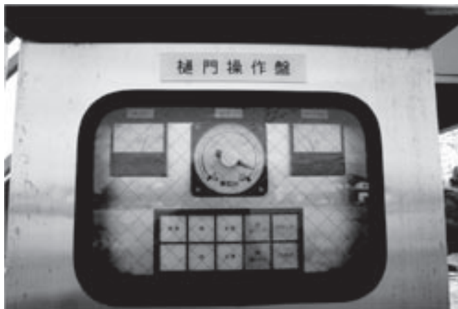
資料 11 (水門の操作盤)
