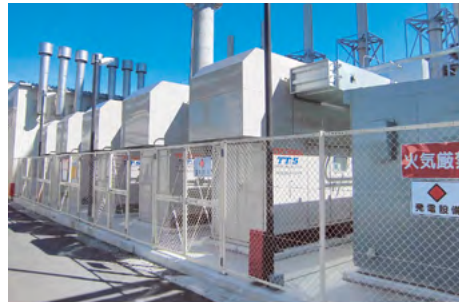
マイクロガスタービンコージェネレーションシステム
