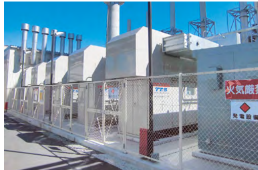
コージェネレーションシステム
