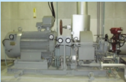
松戸工場スチームタービン発電機
