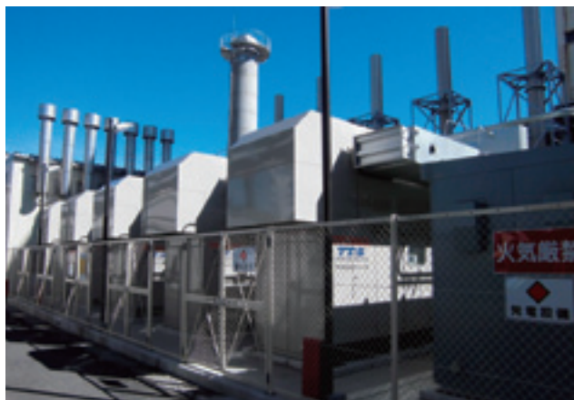
マイクロガスタービンコージェネレーションシステム 発電用ガスタービンから排出される高温の排気によって蒸気を作ることで燃料を効率的に利用しています。
