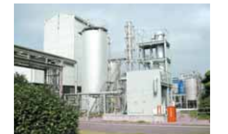
焼酎かす飼料化設備
