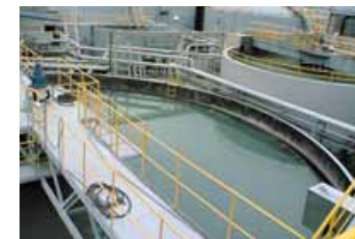
排水処理設備
