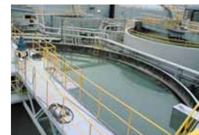
排水処理設備
