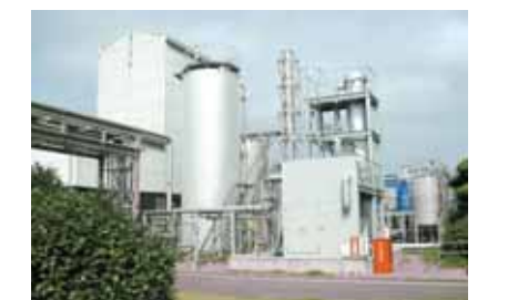
焼酎かす飼料化設備
