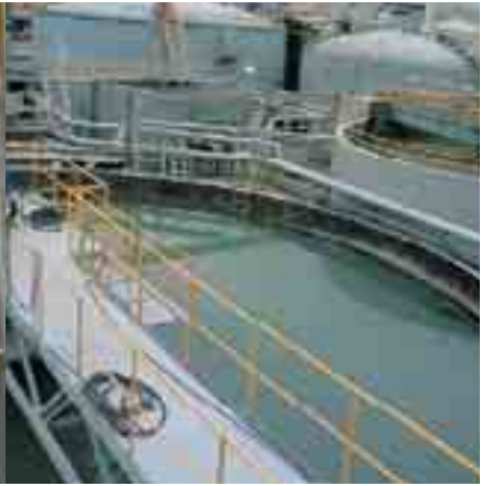
排水処理設備
