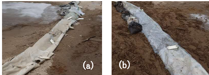
図2. 既存柵の状況(2022年4月下旬). (a)岸側(図の上部)に破損が見られた。(b)補修後.
